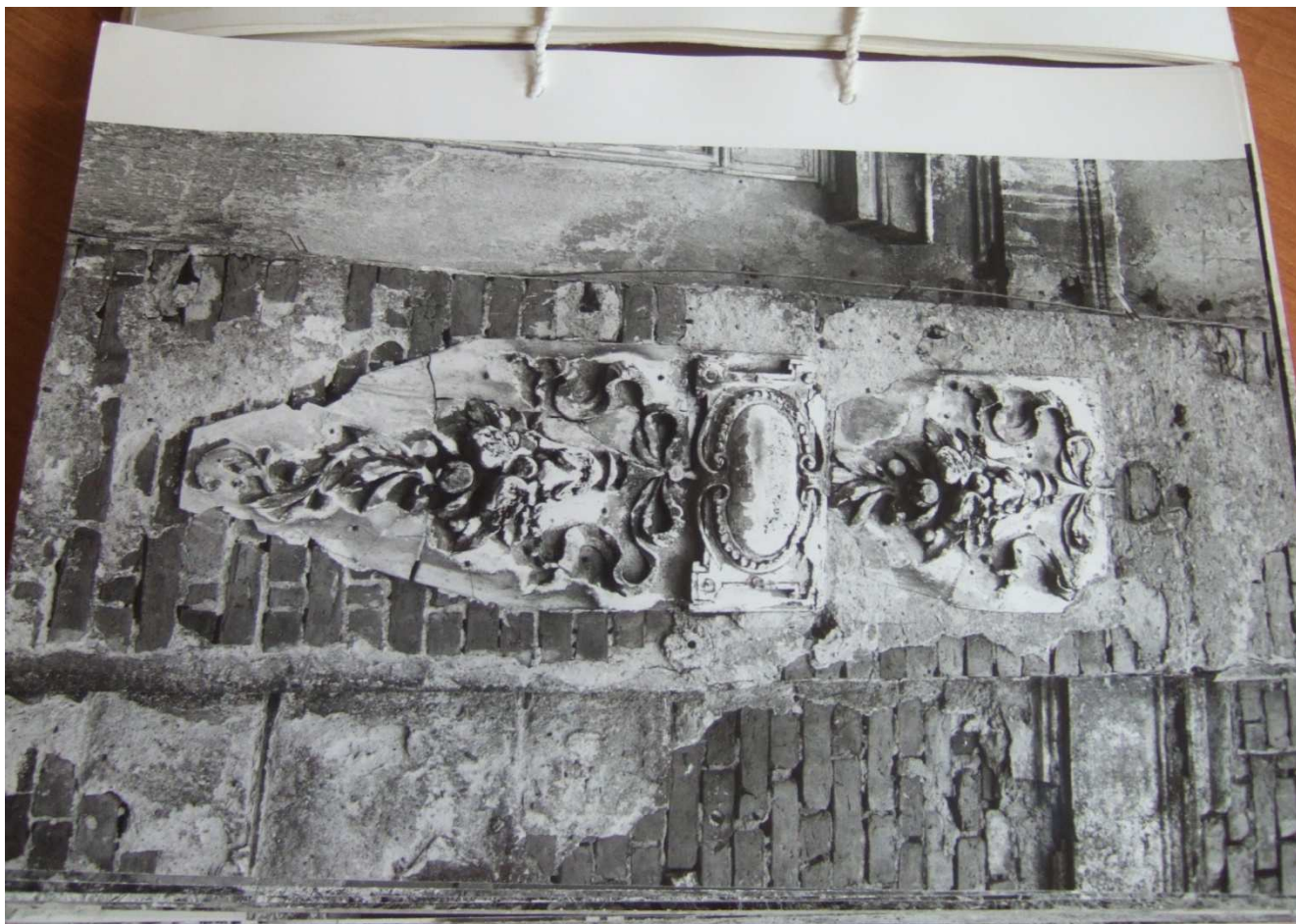
Coraz bardziej żałosne i coraz mniej liczne pozostałości po dawnej elewacji
